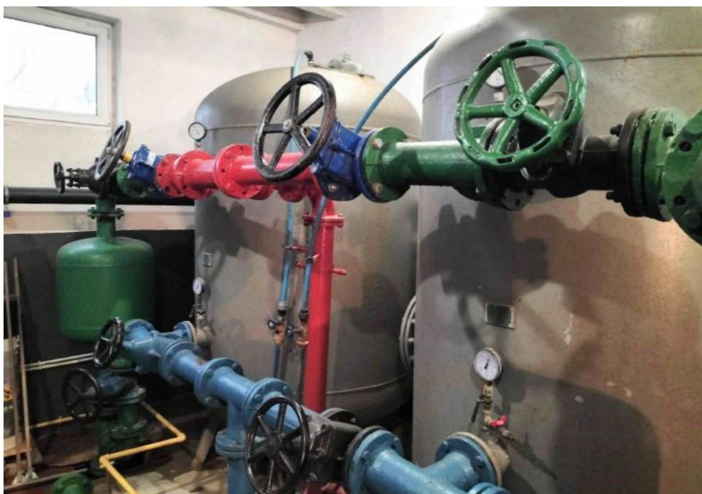
Zdj. nr 2 Filtry na stacji uzdatniania wody w Boguszewie
