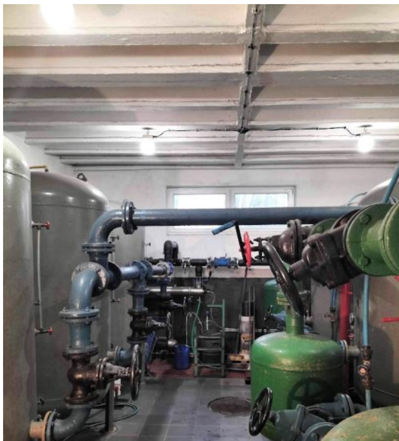
Zdj. nr 1 Stacja Uzdatniania Wody w Boguszewie.
