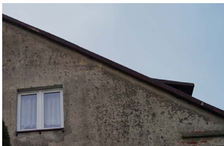
Fot. Elewacja zachodnia. Pomiedzy murem, a dachem szczelina i widoczne obielenia odchodami świadczące o obecności ptaków w tej przestrzeni.
