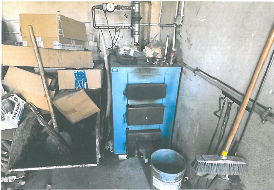
Źródło ciepła - kocioł o mocy 36 kW opalany węglem kamiennym.
