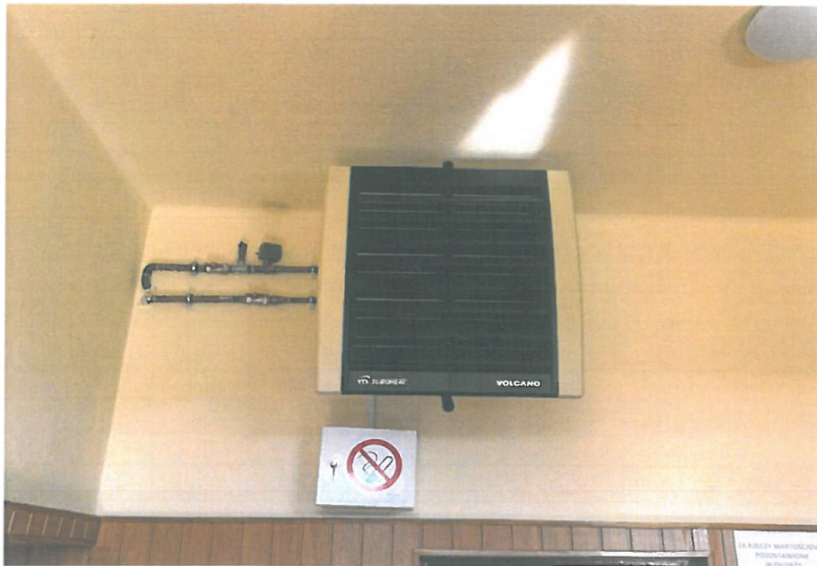
Nagrzewnica powietrz zasilana z kotła węglowego.
