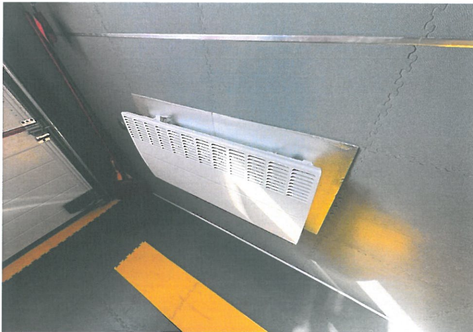
Awaryjny grzejnik elektryczny w pomieszczeniu garażu.
