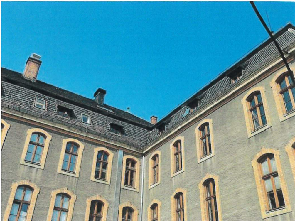
Elewacje od strony podwórka. Kominy z cegły klinkierowej - do remontu. Obudowy wyrzutni zostaną obłożone z zastosowaniem drobnych płytek włóknowo-cementowych (krycie niemieckie), sterczyny dachowe do odtworzenia na wzór istniejący (z zastosowaniem blachy miedzianej).
