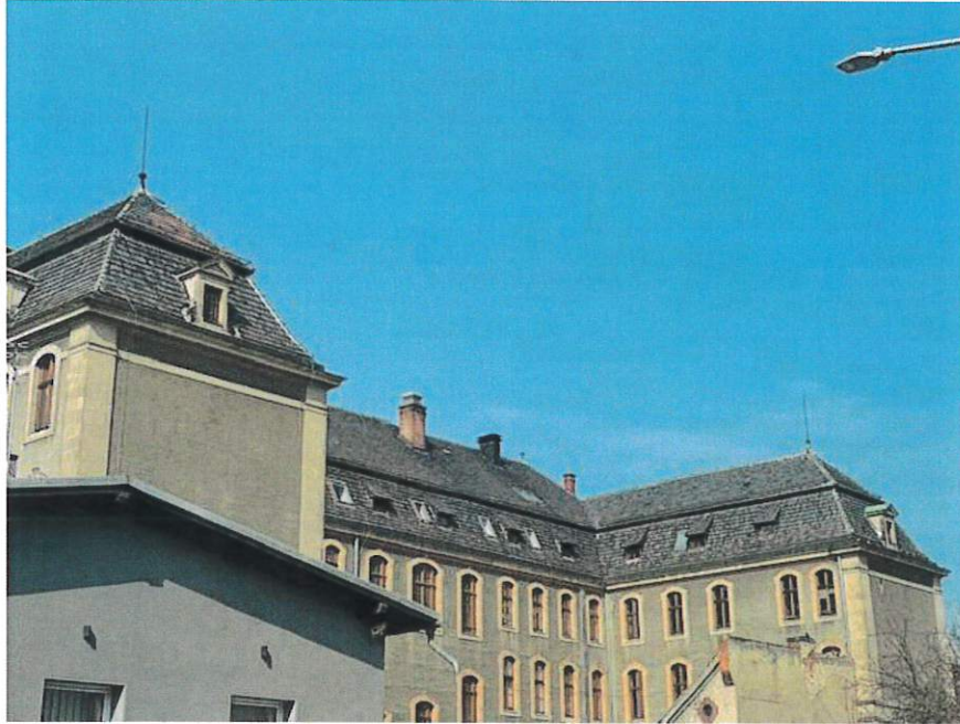
Widok dachu w elewacji tylnej. Przewidywany remont małych lukarn w elewacji tylnej.
