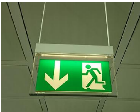
Fotografia przyjętego rodzaju oświetlenia dróg ewakuacyjnych
