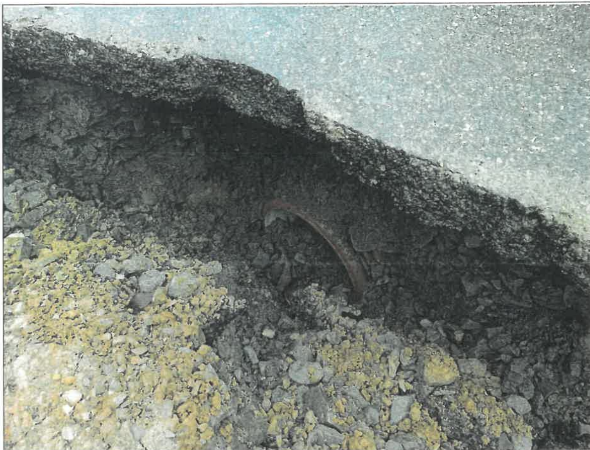
Uszkodzenie odpływu w skarpie głównej osuwiska
