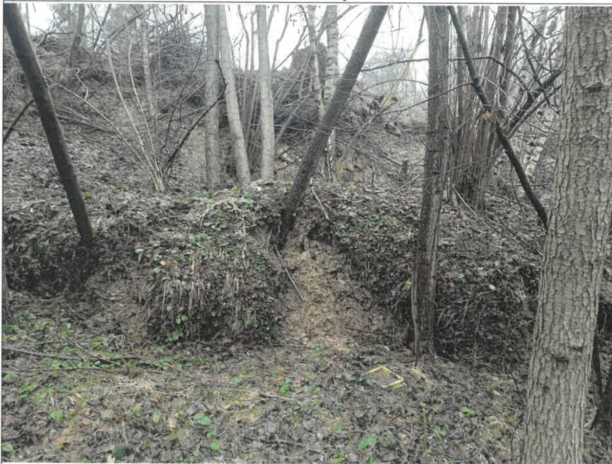
Przemieszczenia w obrębie nasypu
