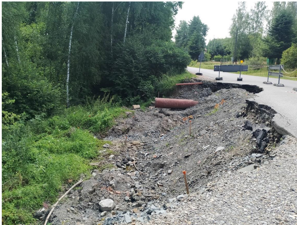
Rys. 2. Widok na skarpe główną osuwiska
