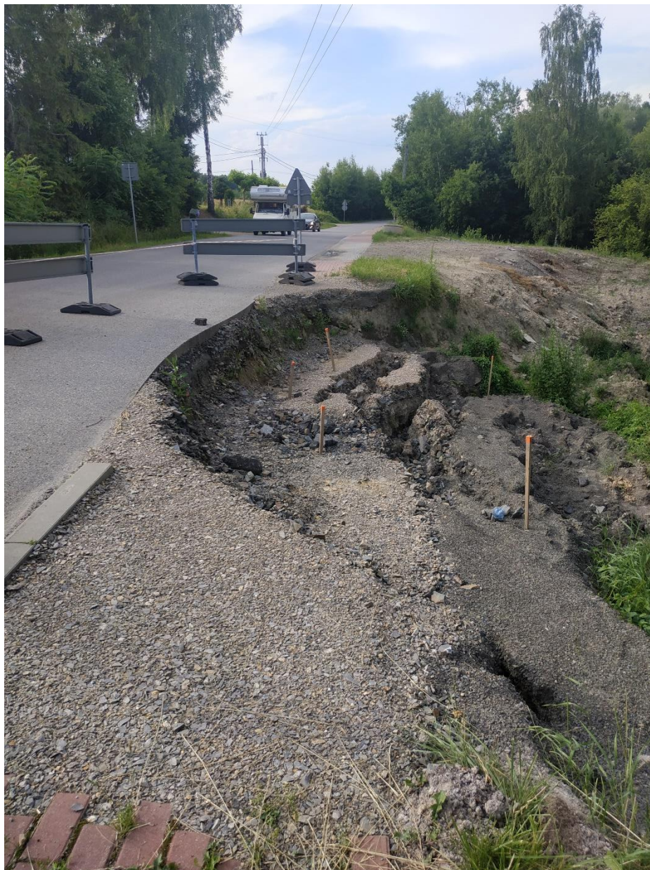
Rys. 1. Widok na skarpe główną osuwiska
