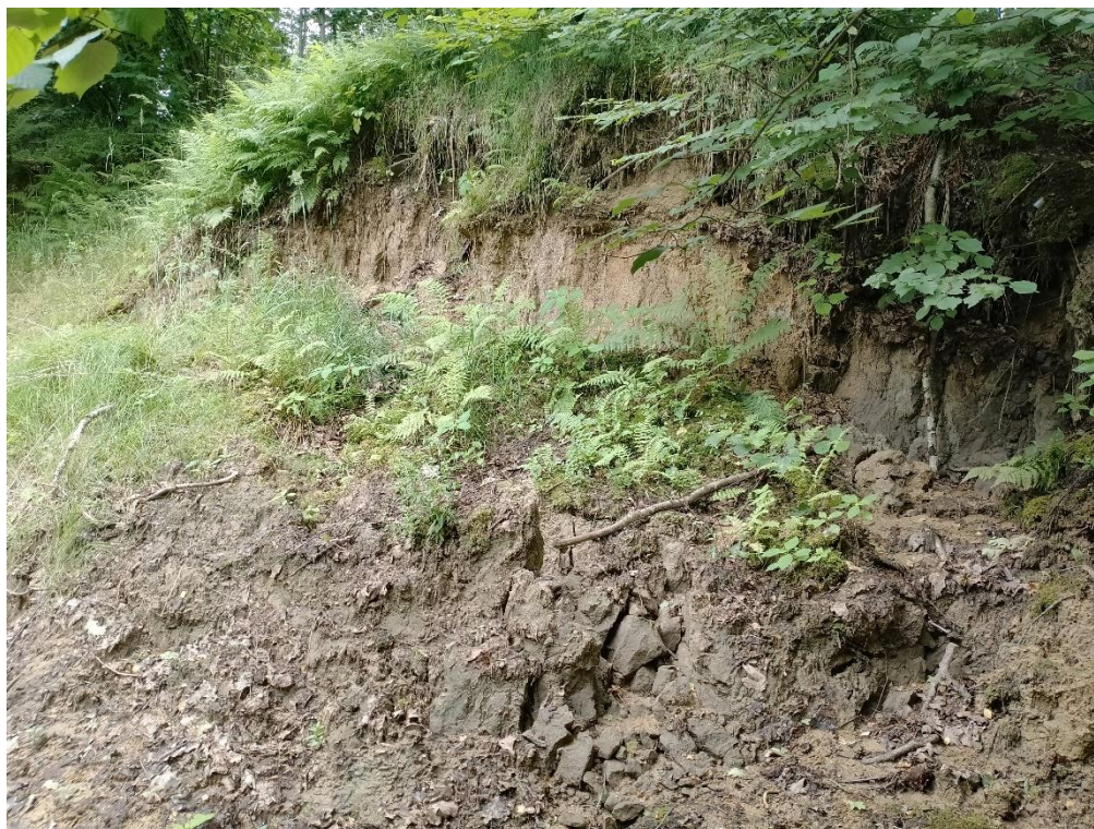
Rys.4. Obryw w lesie, poniżej skarpy głównej, w południowej części osuwiska
