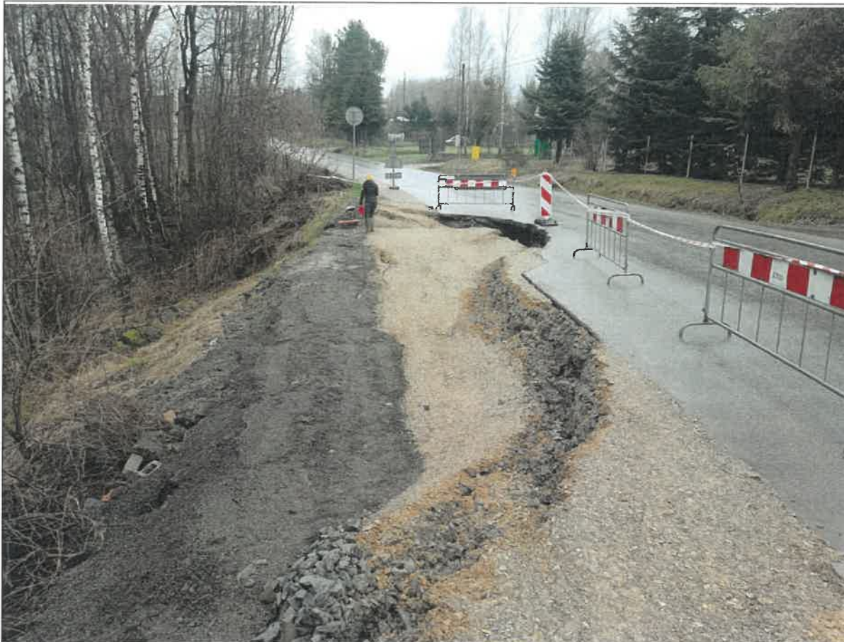
Skarpa główna osuwiska - uszkodzenie jezdni
