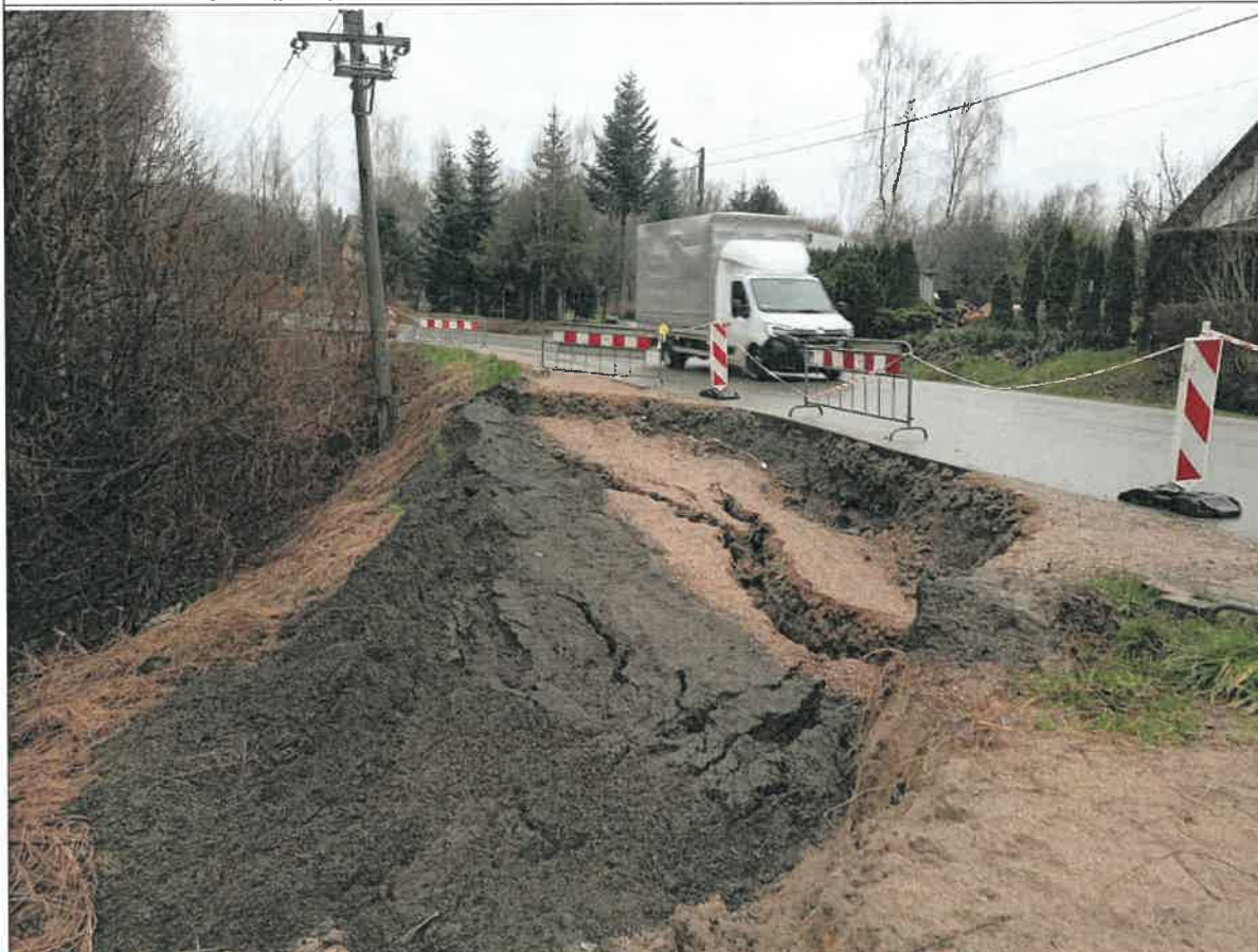
Skarpa główna osuwiska - uszkodzenie korpusu drogi powiatowej
