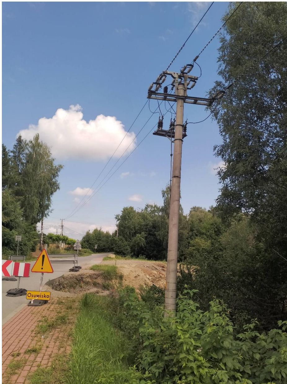
Rys. 3. Słup energetyczny na terenie osuwiska, pochylony w kierunku wschodnim
