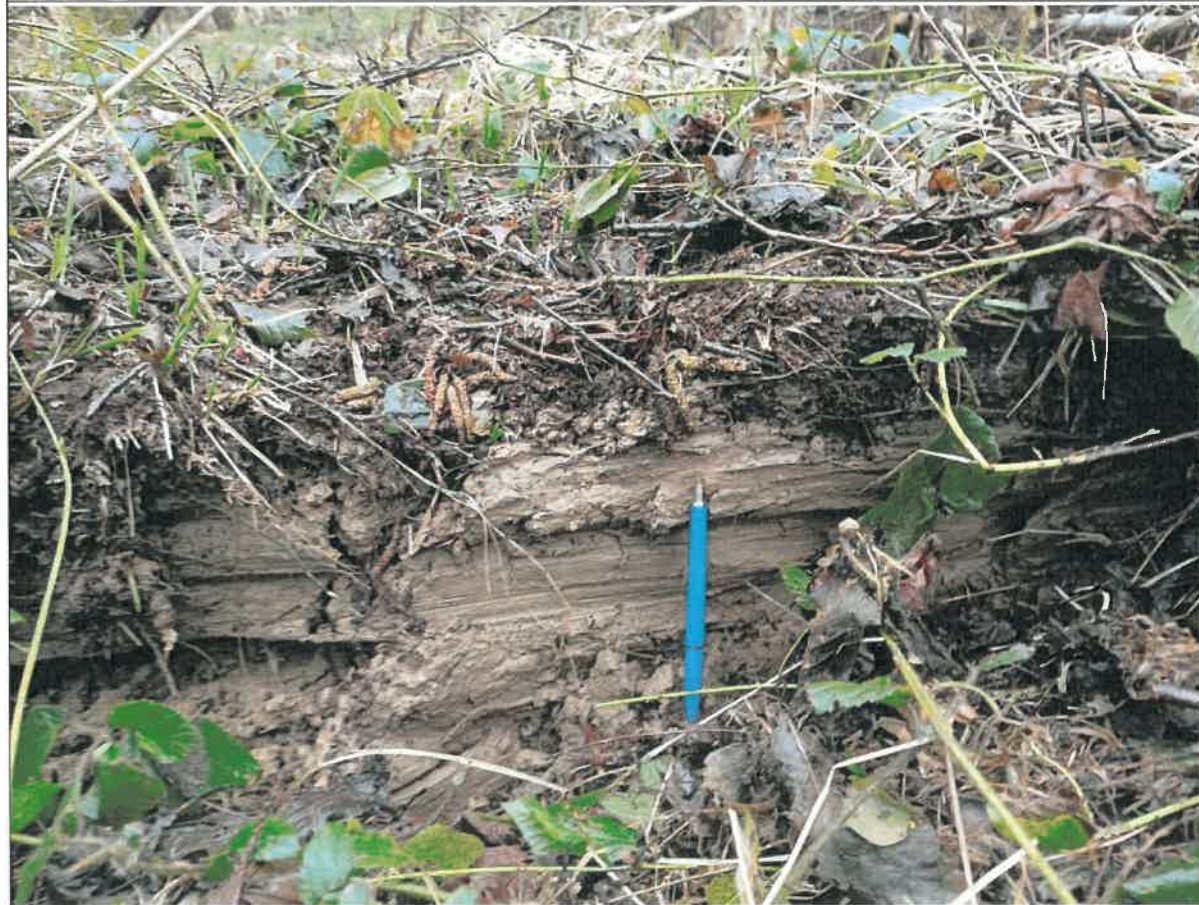
Powierzchnia poślizgu poniżej nasypu
