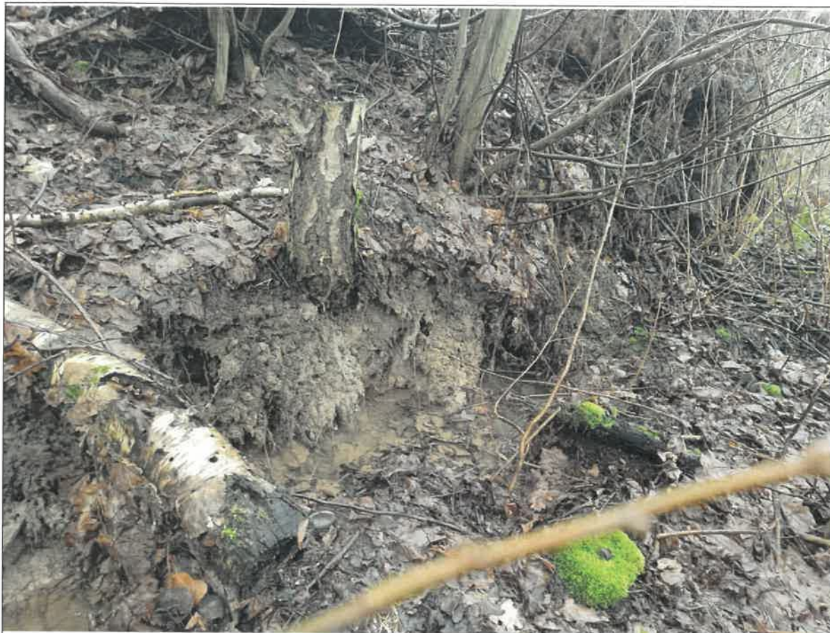
świeża "zerwa" poniżej uszkodzonego korpusu drogi
