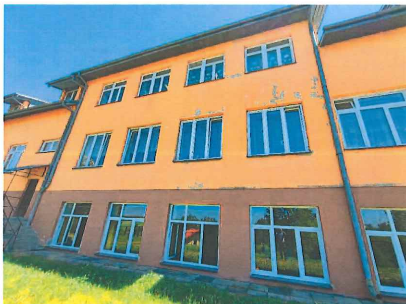
Rys. 6.1 Widok uszkodzonego tynku na elewacji.
