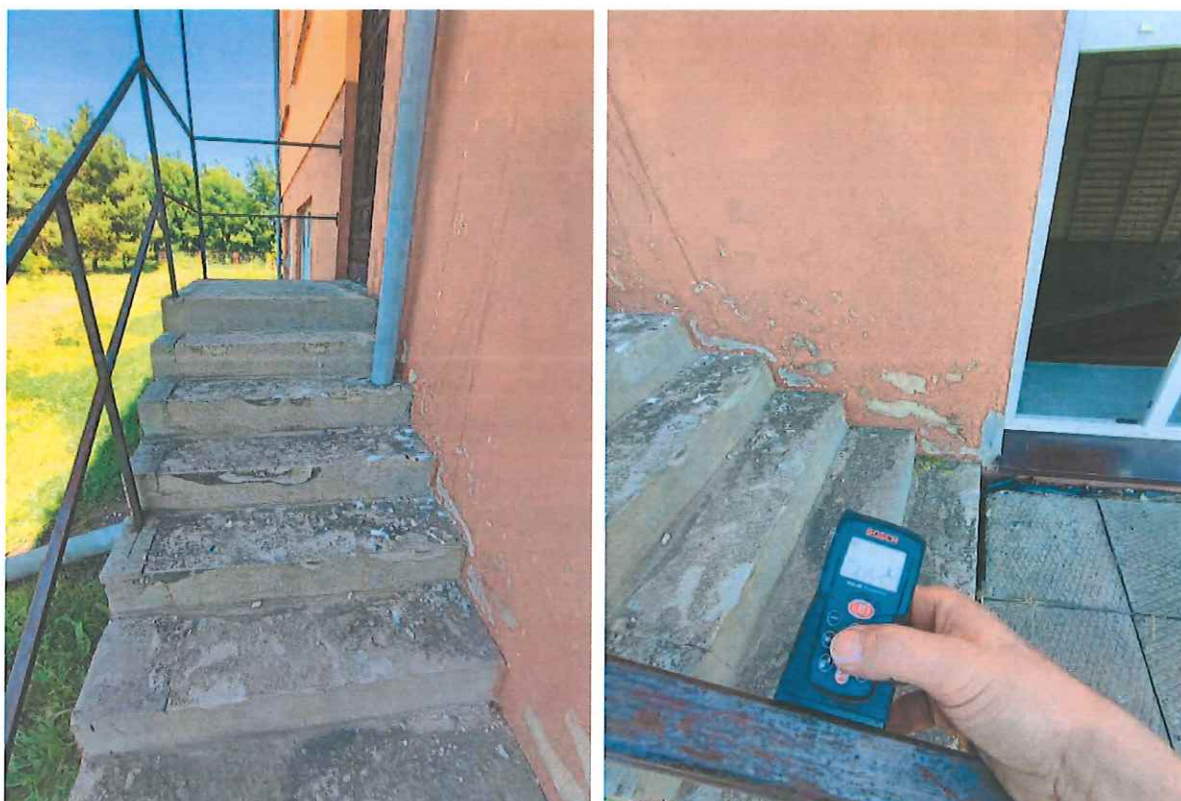
Rys. 6.2 Uszkodzone schody zewnętrzne.
