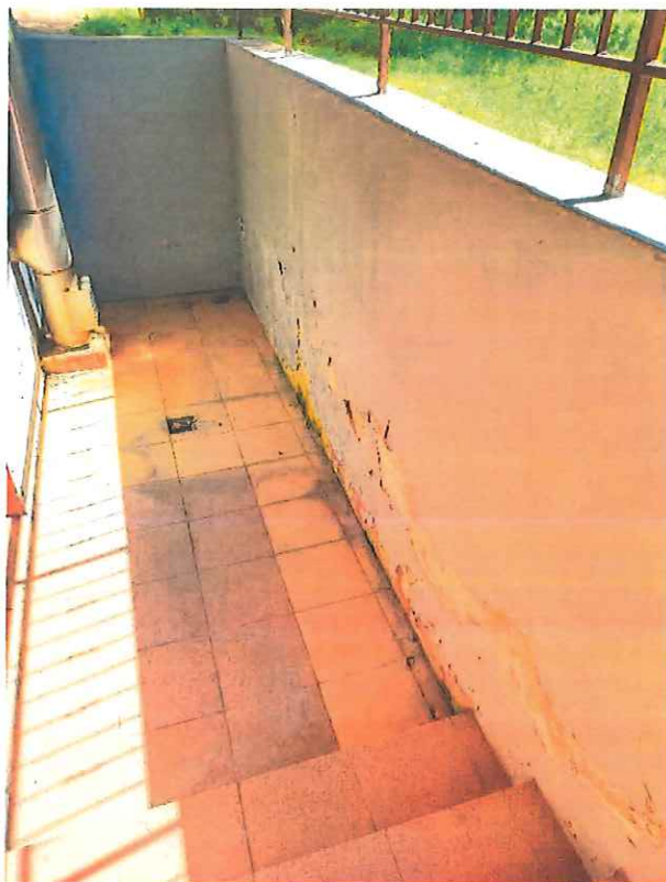
Rys. 6.3 Odspojony tynk na ścianie oporowej.
