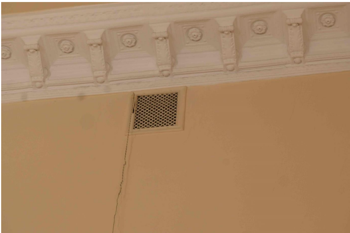
6. Sala Rozpraw nr XIII. Widok detalu sztukatorskiego na suficie i kratki wentylacyjnej.
