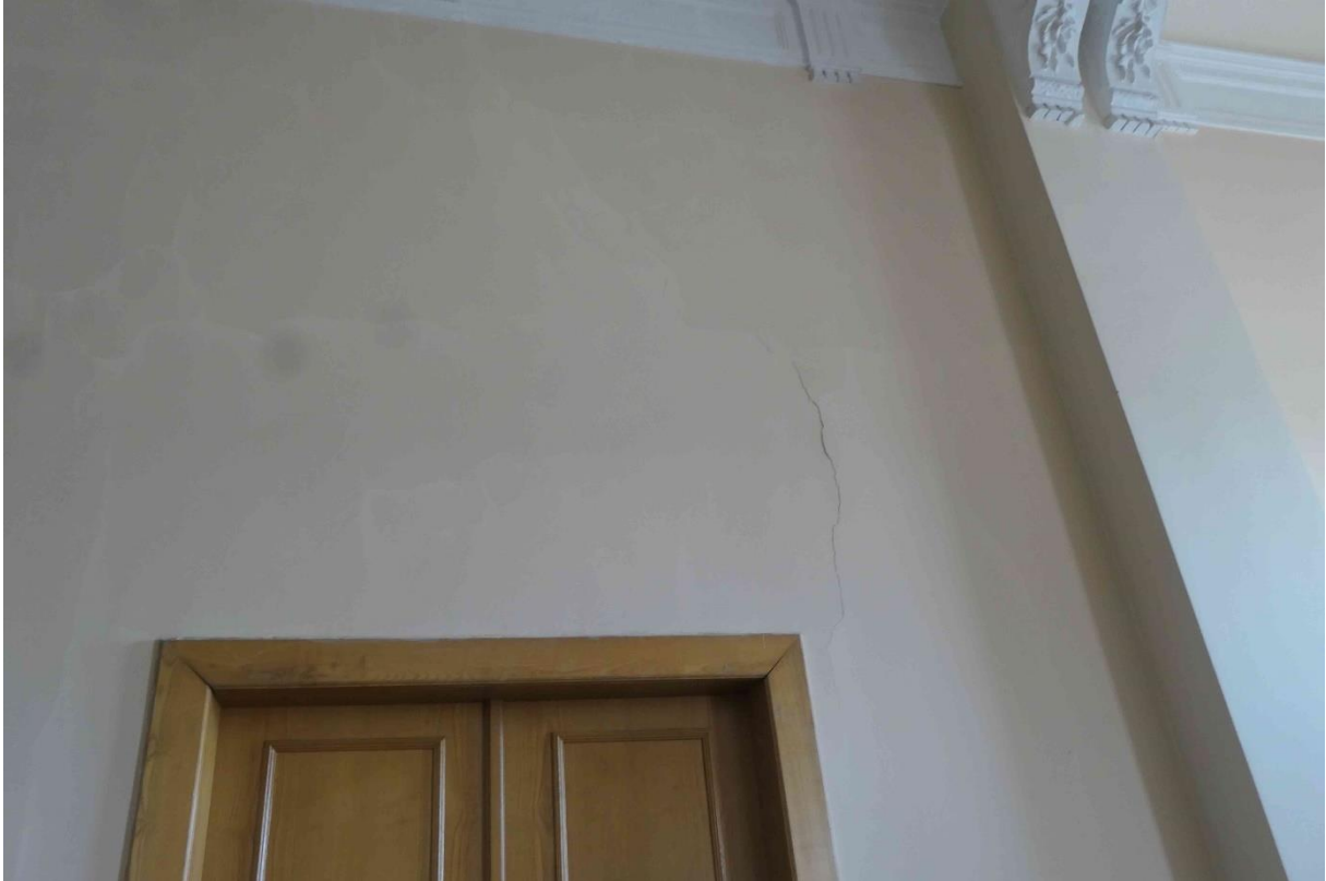
13. Sala Rozpraw nr XVI. Uszkodzenia tynku.
