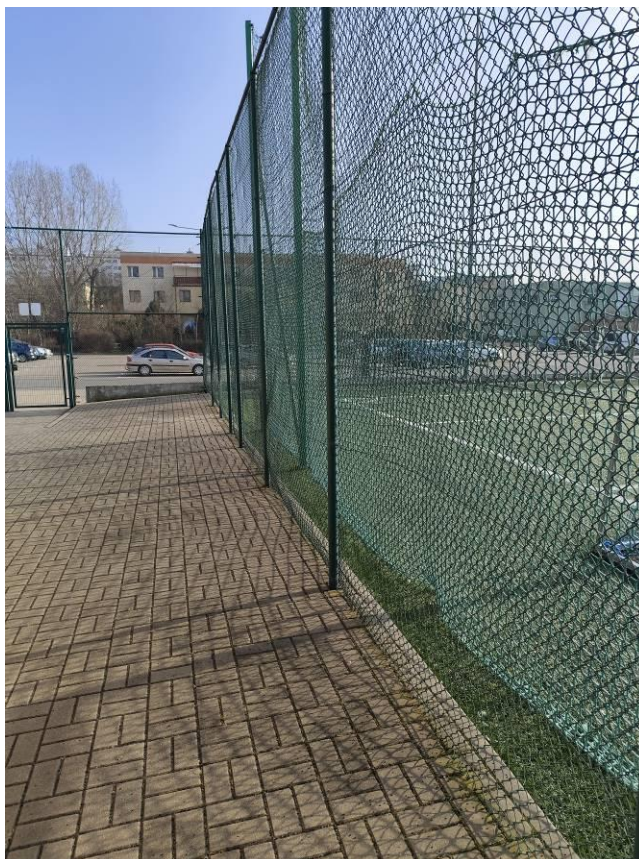
Siatka ogrodzeniowa do naprawy / wymiany
