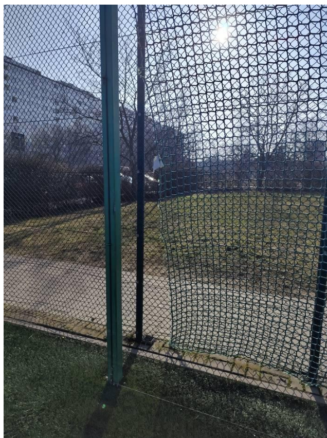
Zniszczenie siatki piłkochwyłów przeznaczone do wymiany
