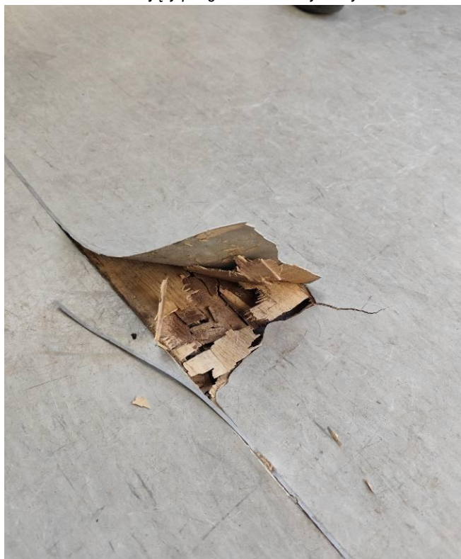
Zniszczenia posadzki w szatni przeznaczona do naprawy
