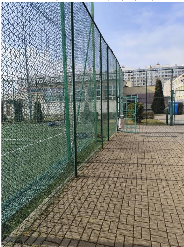
Siatka ogrodzeniowa do naprawy / wymiany
