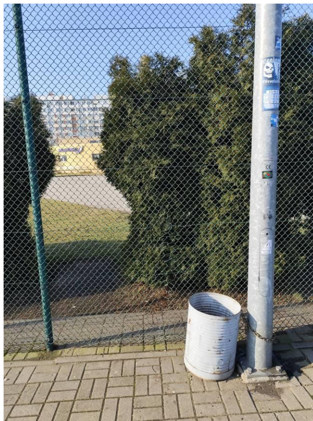
Uszkodzenie siatki ogrodzenia
