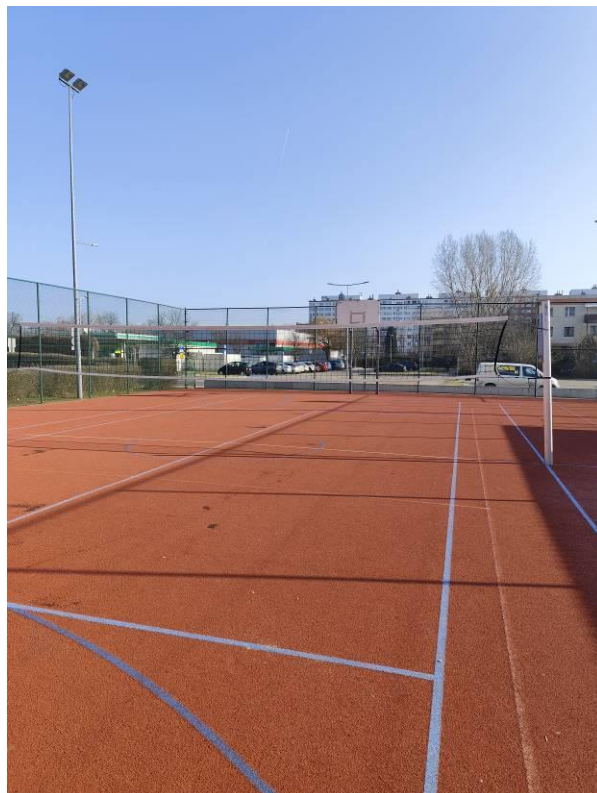
Nawierzchnia boiska do wymiany
