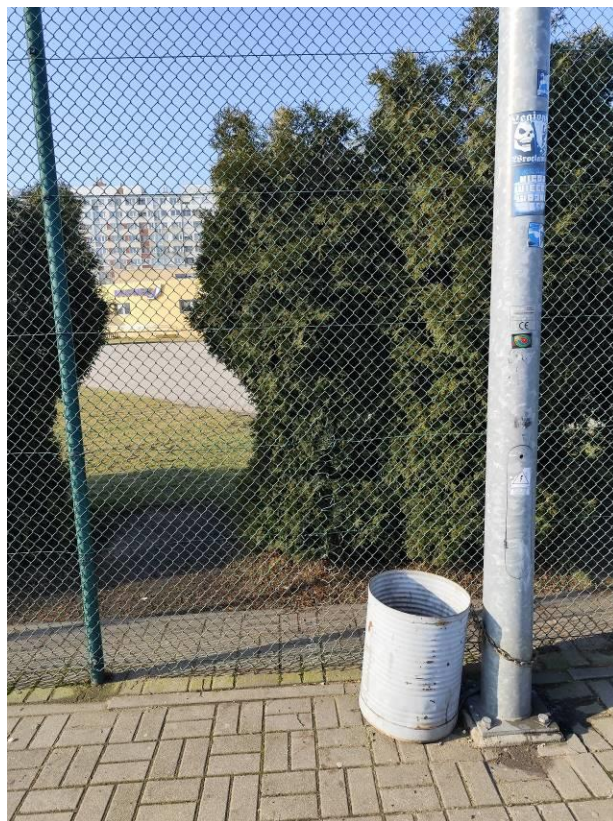
Uszkodzenie siatki ogrodzenia
