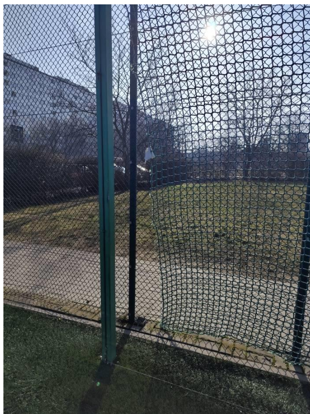
Zniszczenie siatki piłkochwyłów przeznaczone do wymiany
