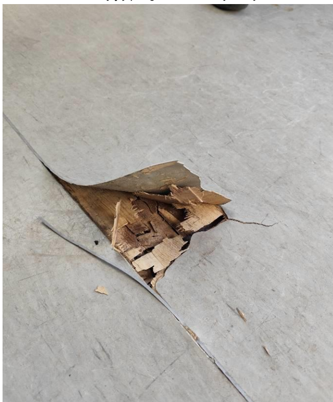
Zniszczenia posadzki w szatni przeznaczona do naprawy
