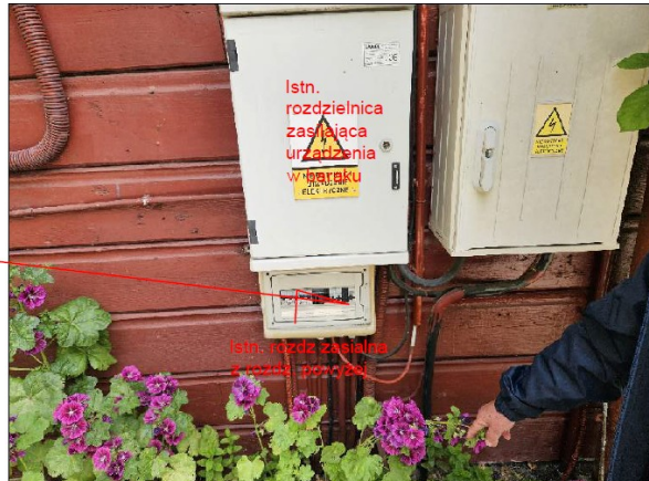
UKŁADY ROZDZIELNIC POMIAROWO-ZASILAJĄCYCH NA STADIONIE W SOPOCIE
