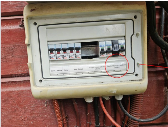
Istn. rozdzielnica do wymiany. Uzgodnić z Użytkownikiem, które obwody pozostają, a które należy zlikwidować
